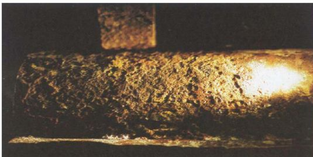
خوردگی نقطه شبنم در دوره های خارج از مدار بودن
